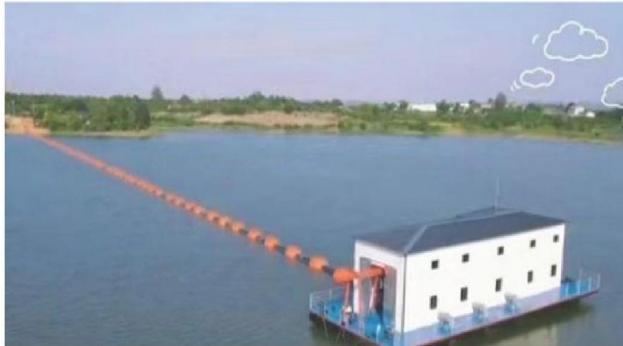
图 2-1 浮筒式取水泵船
