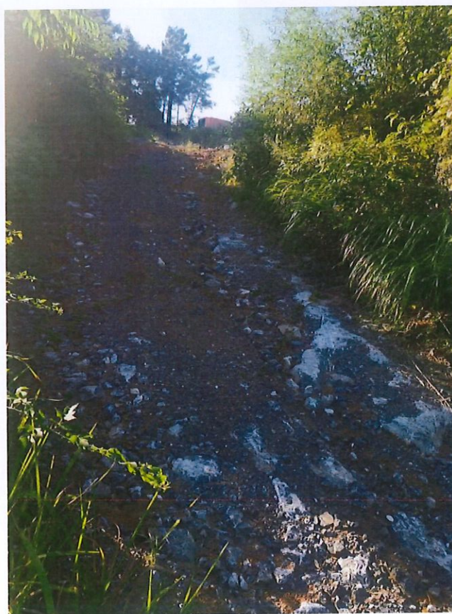
照片 12 矿山道路修建截排水沟整改前
